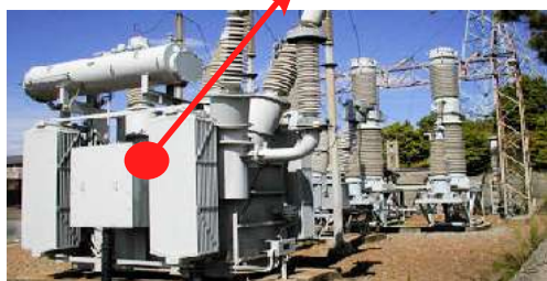
変圧器温度推移管理
