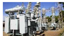
変圧器温度推移管理
