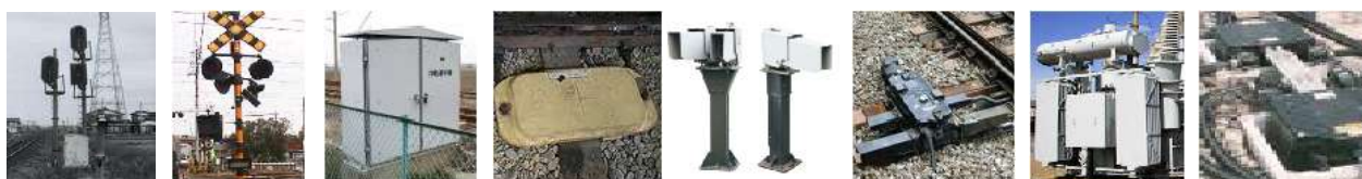
信号電圧監視 踏切電圧 器具箱電圧 ATS送信機 障検制御電圧 転轍機電圧 特高受電電圧 軌道回路電圧
