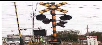
踏切電圧監視
