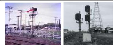
信号機電圧監視
