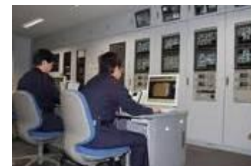
コントロールセンター
