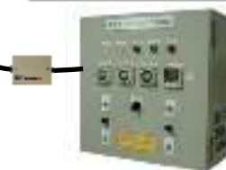
既存盤遠隔制御
