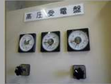
劣化、漏電の監視
