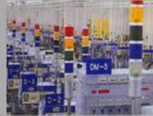
積層灯で稼働管理
