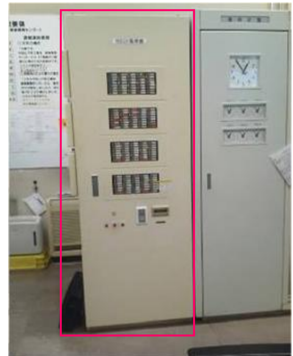
防災センター 160CH自立盤
