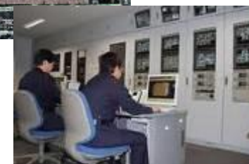
防災センター様事務所
