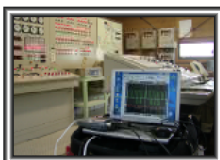
平成2年～現在 碎石散水制御盤 (池田市内)
