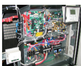
デマンド制御システム
