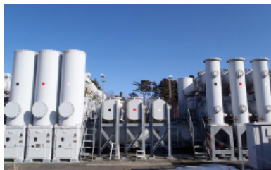
電力会社500,000V開閉所外周監視
