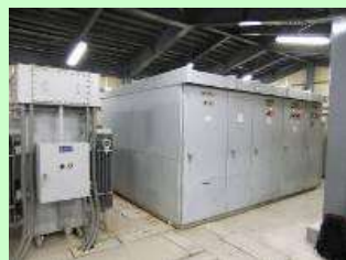
変電所の受電電圧
