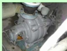
各ポンプ(運転・故障)
