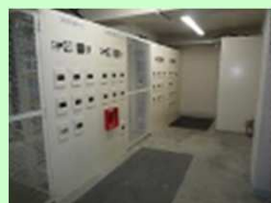
変電設備(電力量・故障等)
