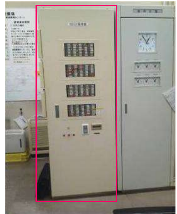
防災センター 160CH自立盤
